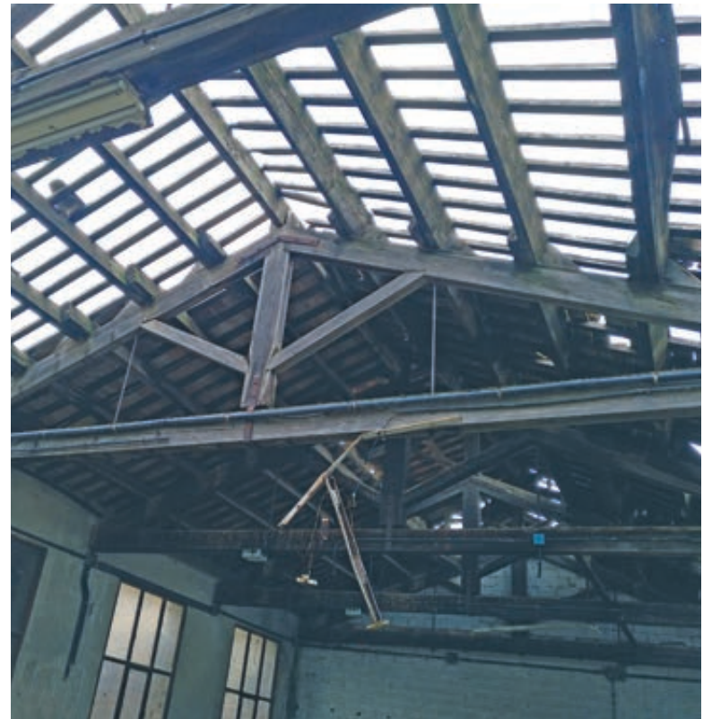
EL DETERIORO DEL RECINTO FABRIL DE LA COLONIA SE HACE PATENTE PASEANDO POR ELLA | FJR
