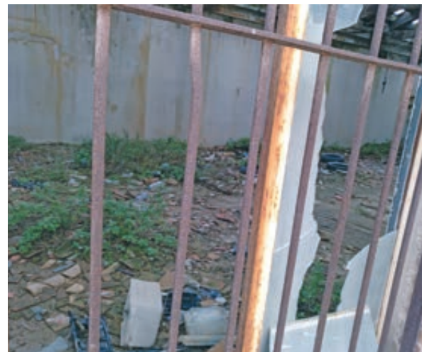
OTRA NAVE EN DESUSO Y EN AVANZADO ESTADO DE DETERIORO | FJR
