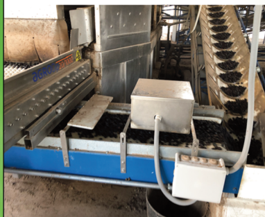
Fotos de instalaciones reales.
