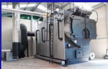
Calderas de Vapor y de Biomasa
