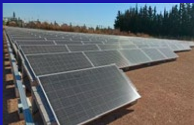
Plantas e Instalaciones Fotovoltaicas
