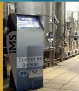
Sistema de Control de Bodega en Almazara
