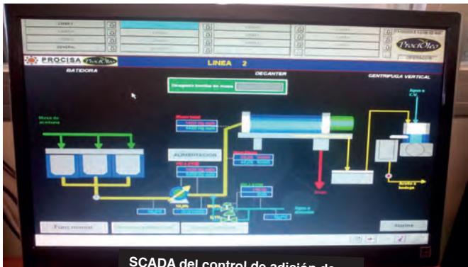
SCADA del control de adición de agua al proceso.
