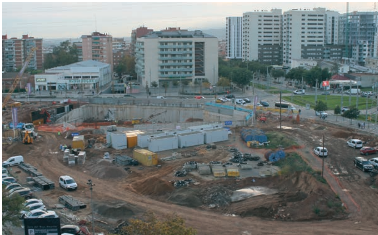
OBRAS DE CONSTRUCCIÓN DE LOS FUTUROS PISOS DE PROTECCIÓN OFICIAL EN EL BARRIO DE LA MONTESA, EN ESPLUGUES. (FOTO: NEREA FERNÁNDEZ)
